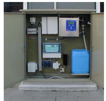
De WS98 vacuüm ingebouwd in een systeemkast
