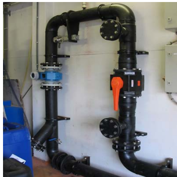
Compleet Meettraject met onderhouds- en kalibratieaansluitingen
