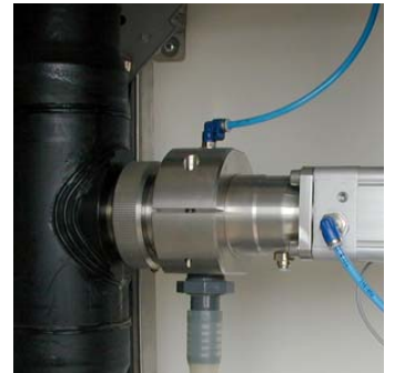
De nablaasvoorziening t.b.v. van het afblazen van restslib
