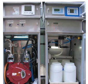
Via een pomp[worden de pH, redox, en drogestofmeter gevoed
