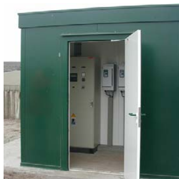
ODS meetthuis met zicht op gemaalcomputer
