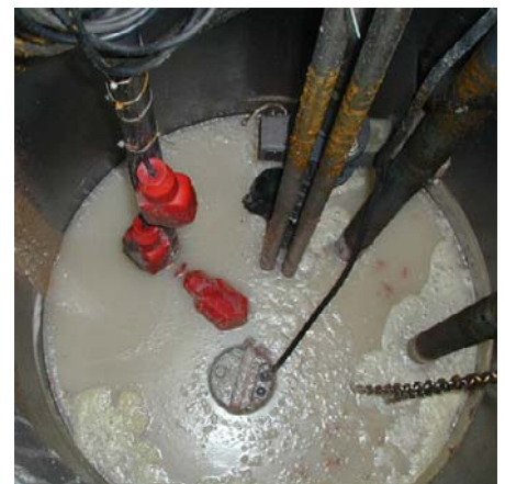
Het uitschakelniveau is te laag gekozen. Men ziet de pomp al
