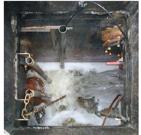
Een pompput waar het water met enorm veel luchtinslag via de pomp wordt aangezogen.
