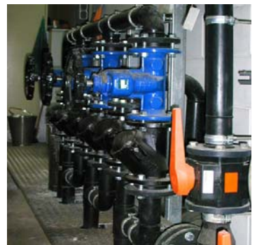
Complex leidingwerk met afsluiters t.b.v. het bijschakelen van buffers
