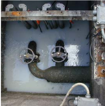
2-pomps installatie bij een chemiebedrijf
