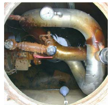
Uit de praktijk. Veel bochten en een ontlufter bleken niet te helpen tegen lucht. Onderin de MID-meter.
