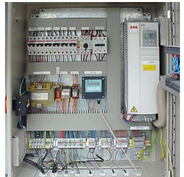
Interieur van een pompbesturingskast
