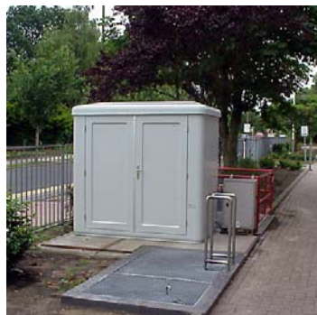
Een Detos-huisje met pompput
