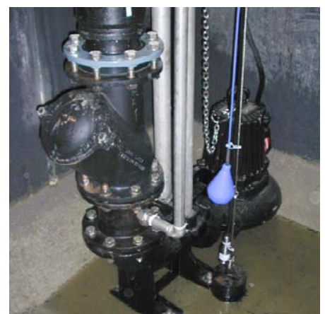
Een grote pomp van een rioolgemaal compleet met balkeerklep
