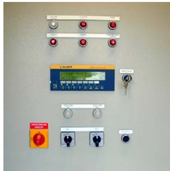
Bedieningspaneel van een gemaalcomputer
