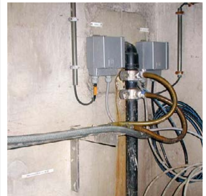
Uit de praktijk. Fout! Horizontale te lange leidingen. Slangenklampen, overgangen, haakse koppelingen
