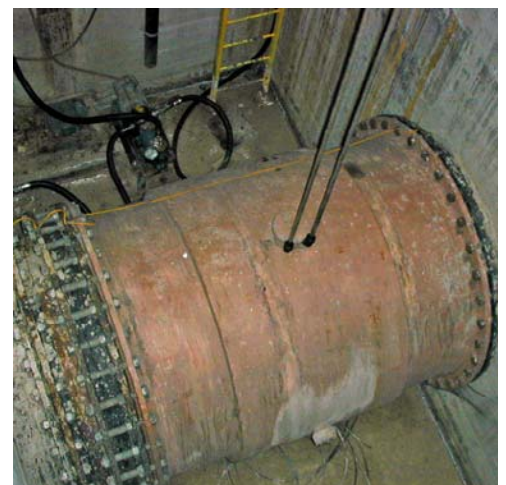
Uit de praktijk. MID-meter met een doorlaat van DN 1000 in een verzopen opstelling.
