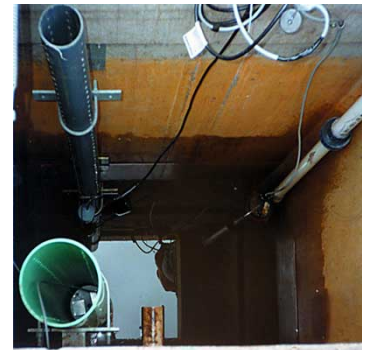
Geperforeerde pijp met ID-221 detector bij rustig stromend water
