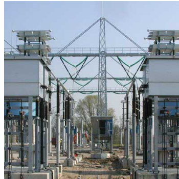
Hoogspanningsschakelstation, een potentiële lekkage locatie
