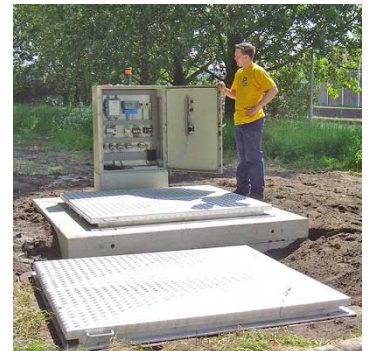
Overzicht van de twee putten en de schakelkast
