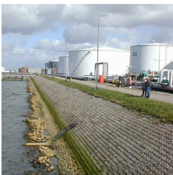
Lozingspunt van regenwater aan de Nieuwe Maas.
