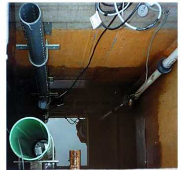
Opstelling met oliedetectoren in een geperforeerde beschermhuis
