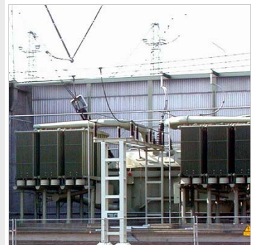
Koelwaterstroom van transformatoren
