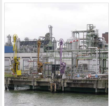
Verlading van olie via laadarmen bij een jetty
