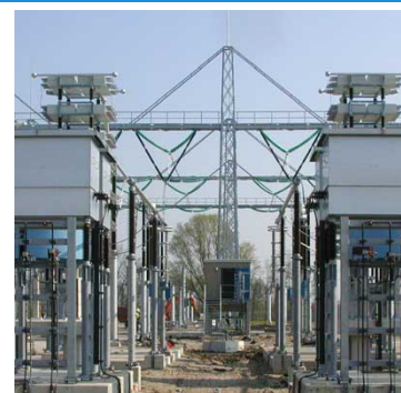
Het hoogspanningsschakelstation bevat grote condensatoren
