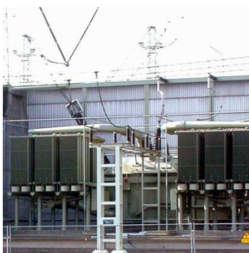
Ook hoogspanningstransformatoren bevatten olie.
