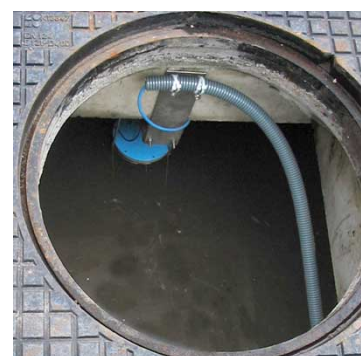
De meetput waarin de oliedetector is geplaatst.
