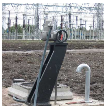
De motorbediende afsluiter sluit zodra er olie gedetecteerd wordt.
