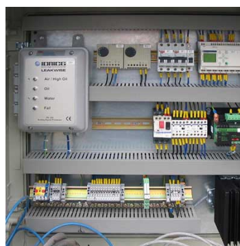
Interieur van de buitenkast met o.a. de transmitter model PS220
