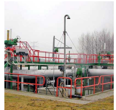
Een schakel en pompstation is omwals met beton.
