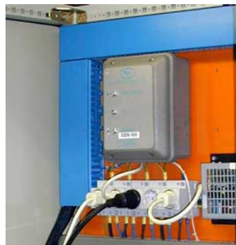
De transmitter PS-220 is netjes in de schakelkast gemonteerd.
