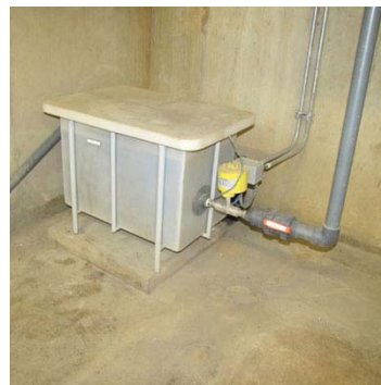
De ODS overloopbak met daarin de ID223/500 sensor
