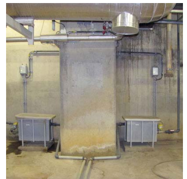
Het nieuwe Leakwise systeem met de ODS overloopbakken
