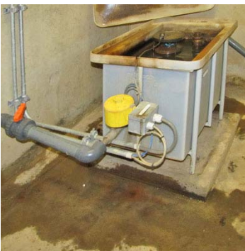
Bewaking van de toevoer met een FCI flowschakelaar
