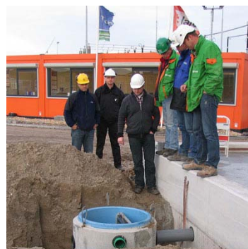
De afloop wordt nog gereinigd met een coalescentiefilter
