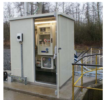
ODS analyser shelter
