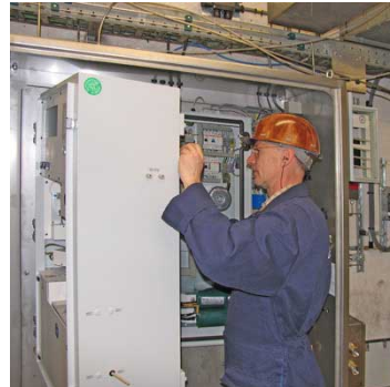
Commissieoning & Start up door ODS
