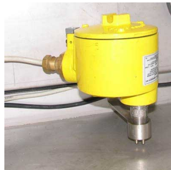
Lekdetectie onder in de EEx-p kast via een FCI switch
