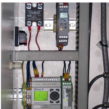
PLC t.b.v. het synchroniseren van de externe monsterverdunning
