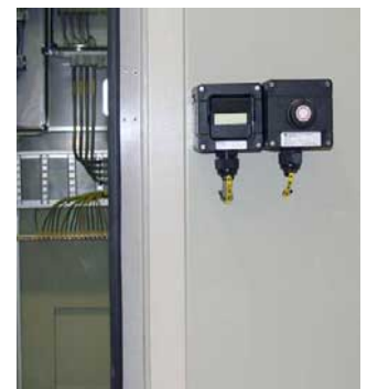
Hoofdschakelaar en reset knop op de buitenwand van het huisje
