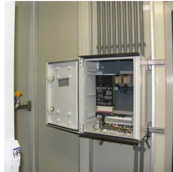
Junction Box met 24 V DC power supply en rijgklemmen
