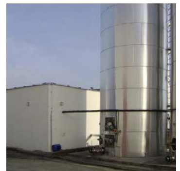
De buffertank waar zwaar verontreinigd afvalwater gebufferd wordt
