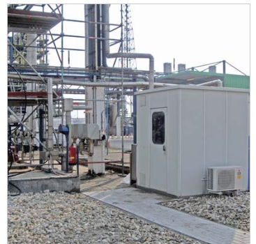
De TOD-analyser is opgesteld in een walk-in shelter
