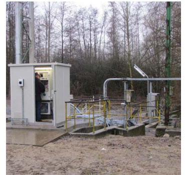
Het walk-in analyser shelter is vlak naast de afvoergoot geplaatst
