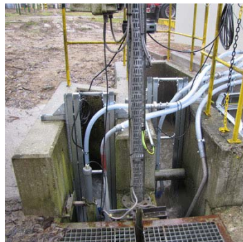
De "fast sample loops" worden gevoerd via pompompen
