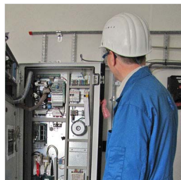
De elektrische componenten in de analyser zijn prima toegankelijk
