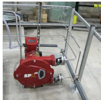
Toerengeregelde slangenpomp en RVS fast sample loop
