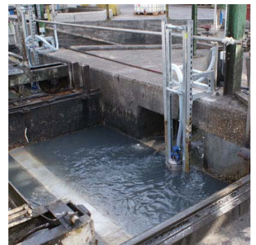
De dempomp hangt in de uitstroomopening
