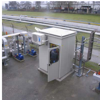
ODS analyser walk-in shelter
