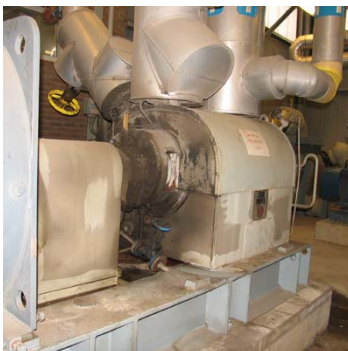
Hogedrukpomp voor het verpompen van ketelvoedingswater
