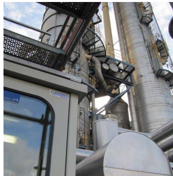
ODS analyser walk-in shelter
