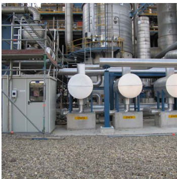
Een Quick-TOC-effluent analyser in een walk-in shelter
