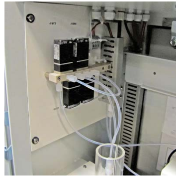
De loop met 3 mm leidingen en 4 stuks block & bleed valves
