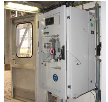
Quick-TOC-loop analyser in een analyser shelter.
