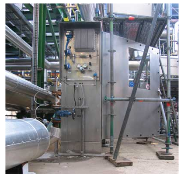
Monsterconditioneringspaneel gemonteerd onder een abri
