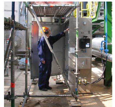
Opstart van de stoomcondensaat- TOC-analyser on-site
