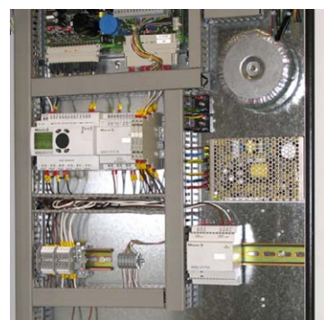
De geïntegreerde PLC-besturing van de stream selector
