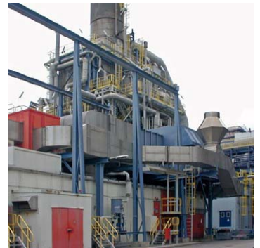
Een deel van de industriële warmtekrachtcentrale
