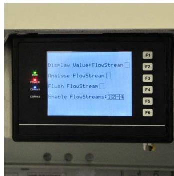
Niet gebruikte stromen kunnen "remote" worden uitgeschakeld
