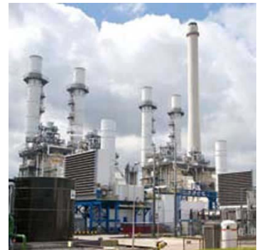
De nieuwe Co-gen produceert maar liefst 700 ton/uur aan stoom
