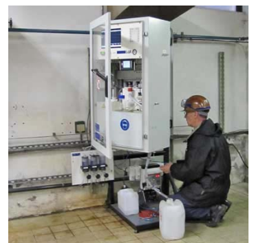
De TOC-analyser is eenvoudig bereikbaar voor onderhoud
