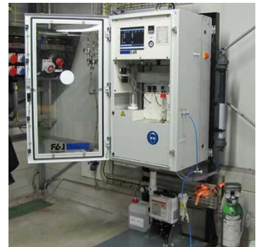
Onder de analyser is een zero air supply geplaatst.
