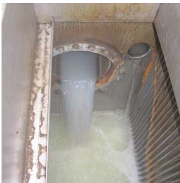
Warm afvalwater van een deelstroom in een kaasfabriek
