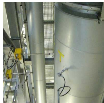
Meten van primaire en secundaire branderlucht voor een boiler
