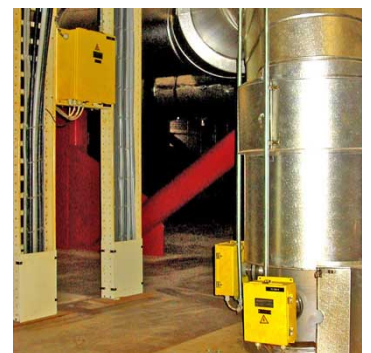
Flowmeting in een grote procesleiding
