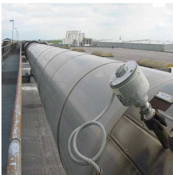
Debietmeting in een heel groot ventilatiekanaal.
