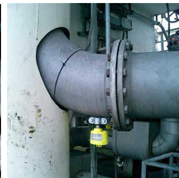
De FCI FTL93 flowswitch bevindt zich in de procesleiding
