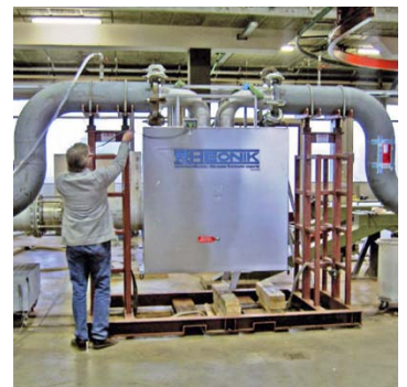
Een vakkundig ingebouwde massa meter.
