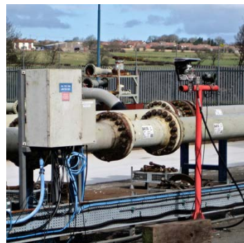
Meter ingebouwd bij Advantica.
